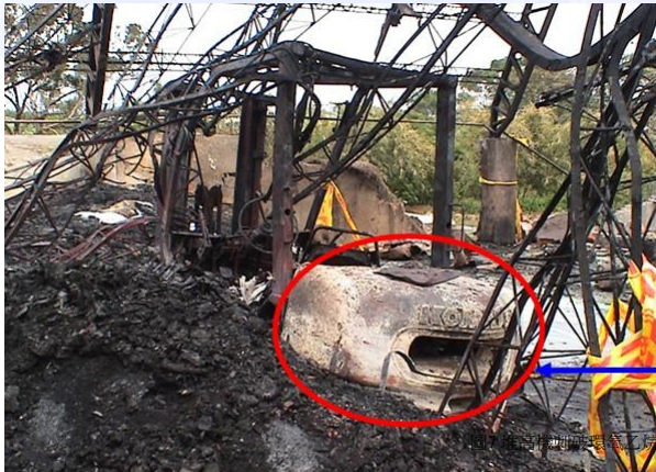
堆高機後端經過高溫燃燒產生材料白化現象（疑似起火點）
